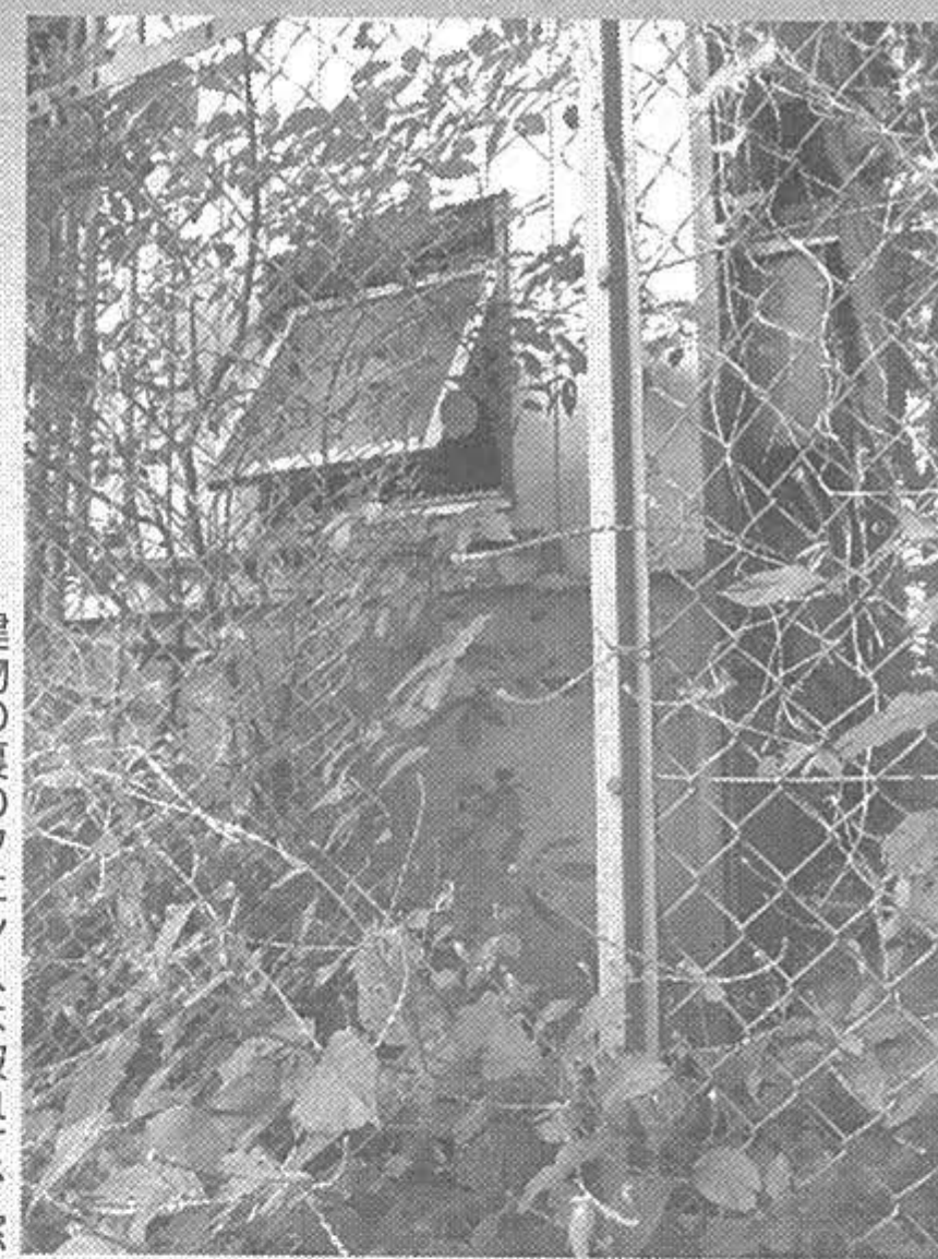
建物の裏のフェンスは破れて、窓から誰でも侵入できる状態に
